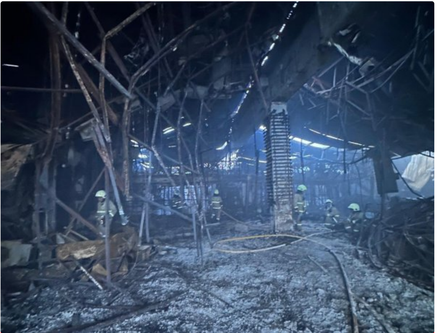
Glodok Plaza yang Hangus Terbakar
